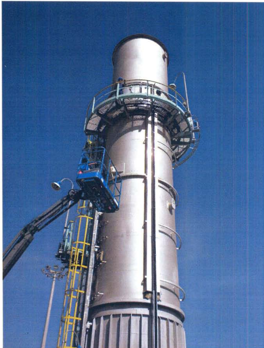
Camino del termodistruttore E020
