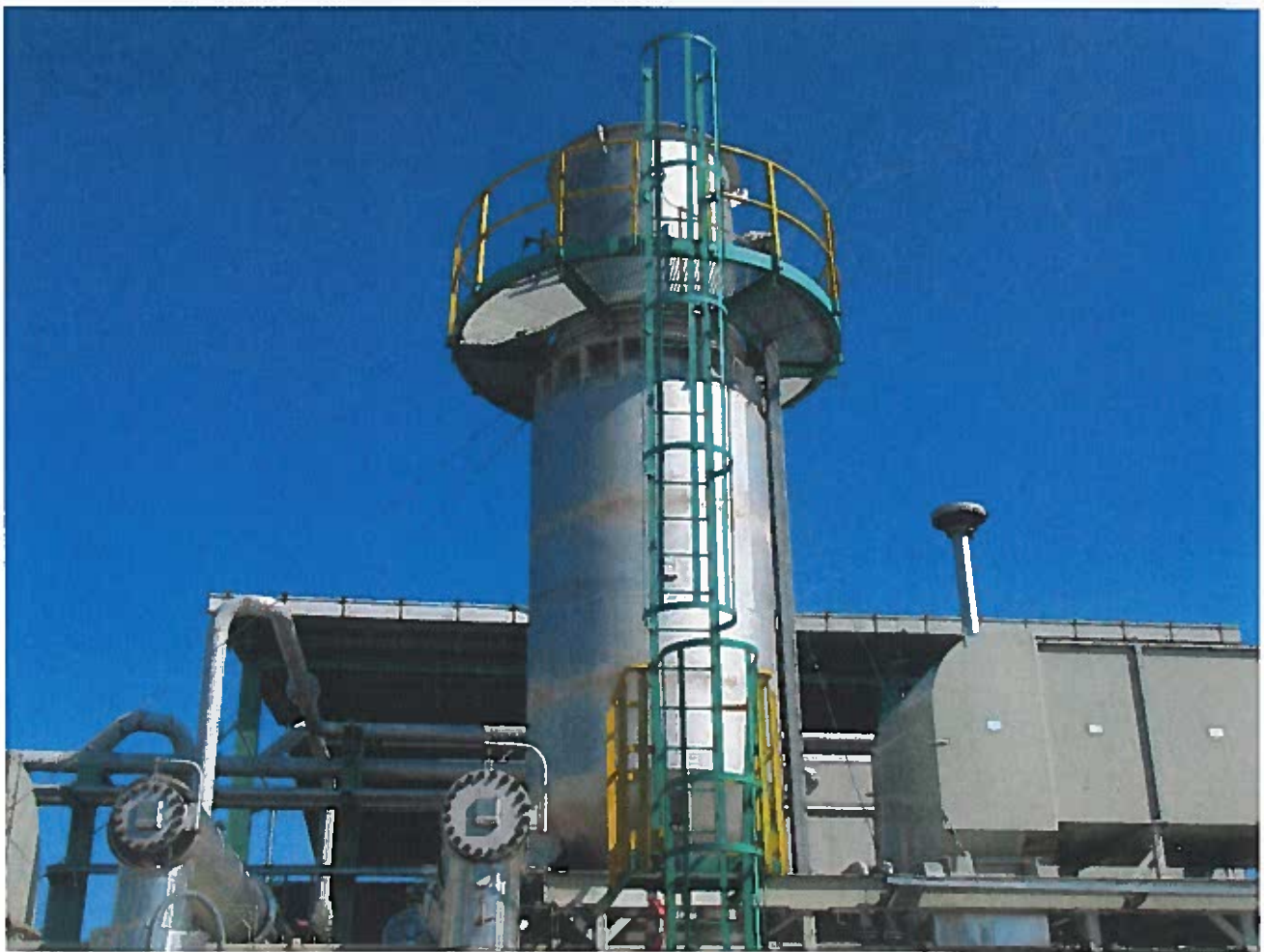
Centrale “Roseto”: Turbocompressore 101
