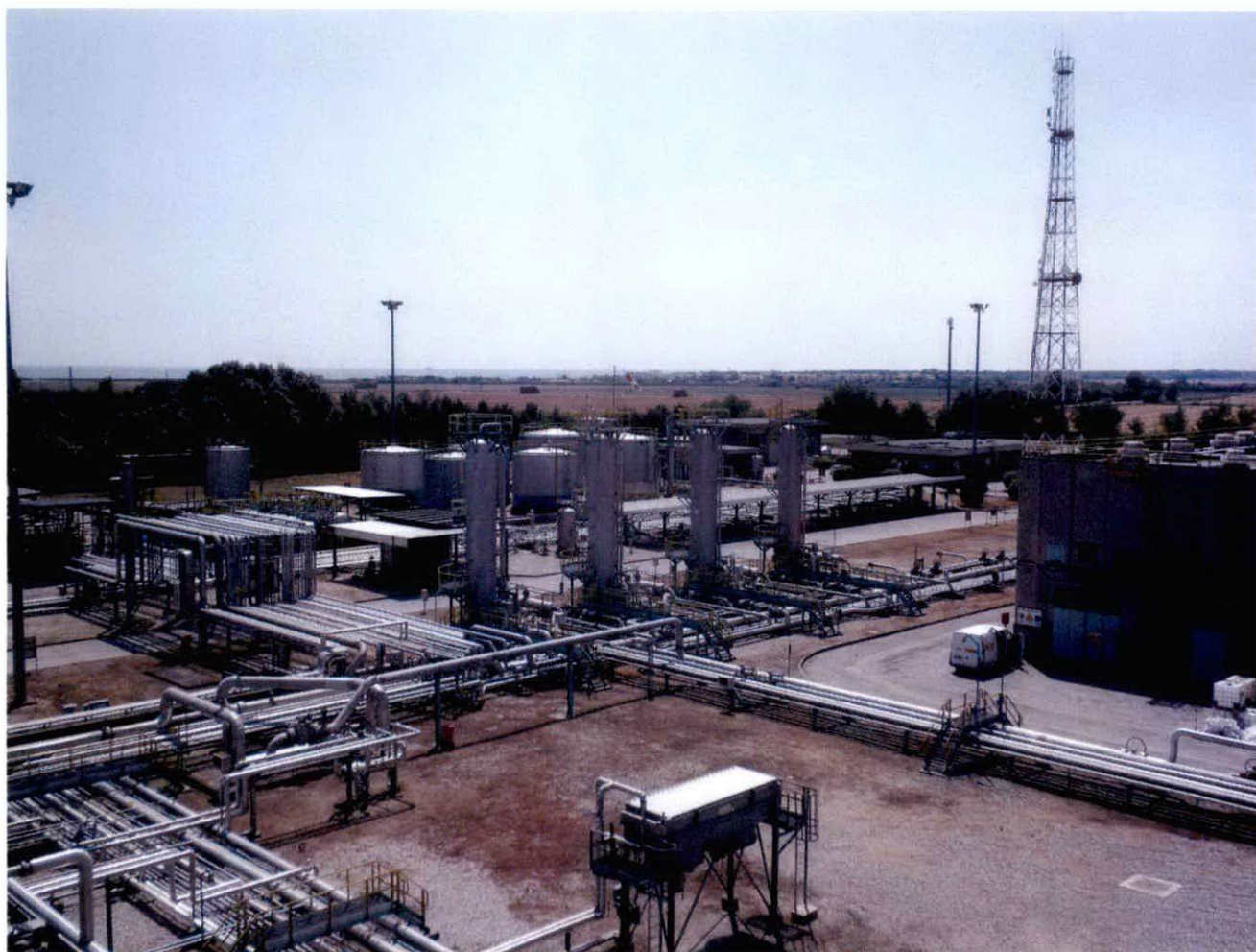
Centrale “Ravenna Mare”
