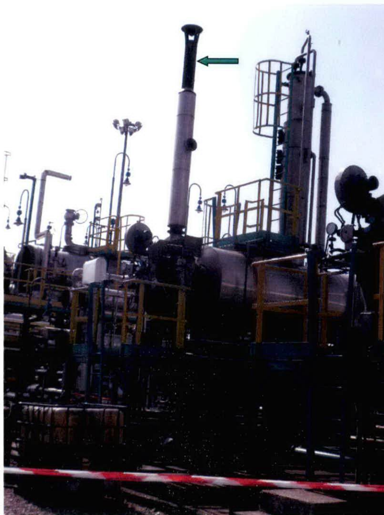
Foto 4: Punto di emissione E22 (camino indicato dalla freccia di colore verde)
