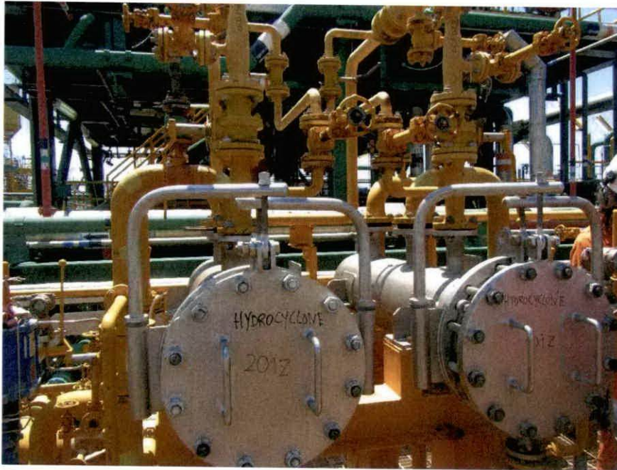
Foto 4 – Impianto di trattamento acque di strato
