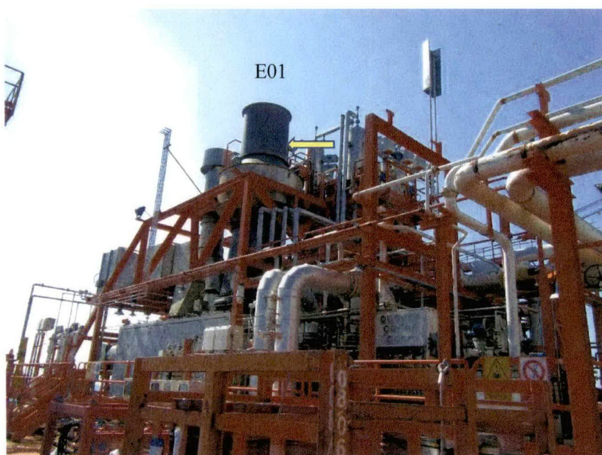
Foto 2 - Punto di emissione attivo E01 con l'indicazione, mediante freccia gialla, della flangia di prelievo.
