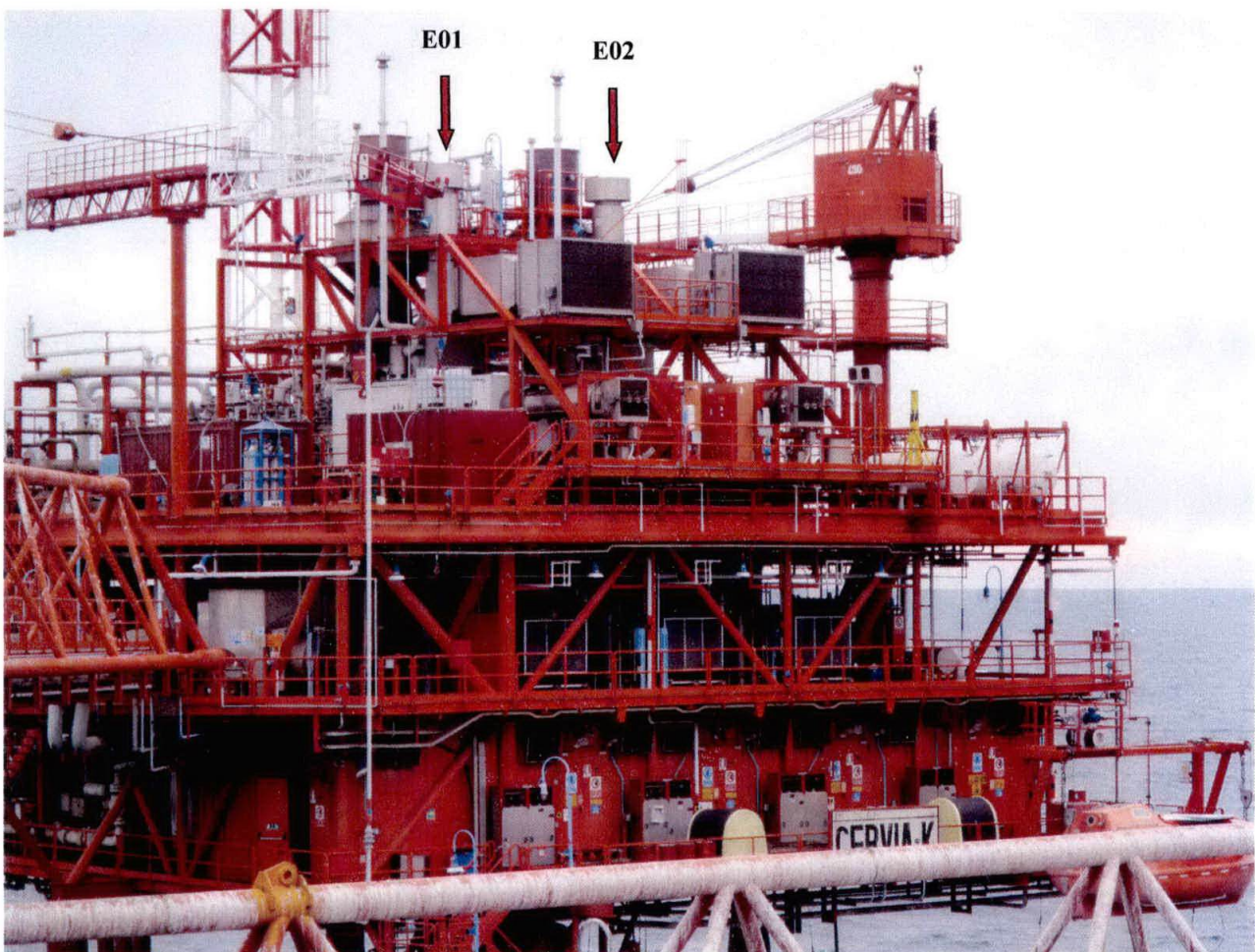
Camini E01 ed E02 dei turbocompressori TK-101 e TK-201
