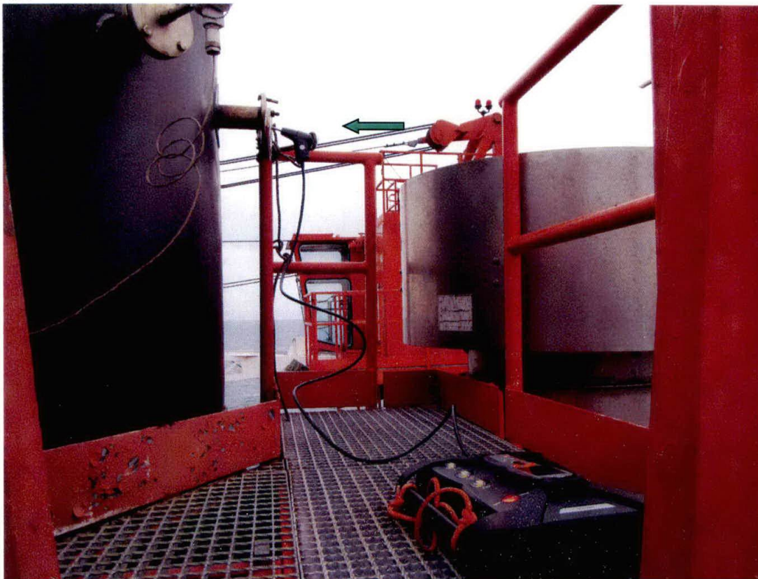
Foto 1: analizzatore "Testo 350" e punto di prelievo nel camino E01 (freccia di colore verde)
