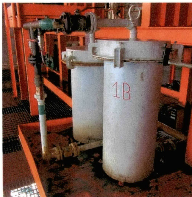
Foto 2 - Impianto di trattamento con filtri a carbone attivo
